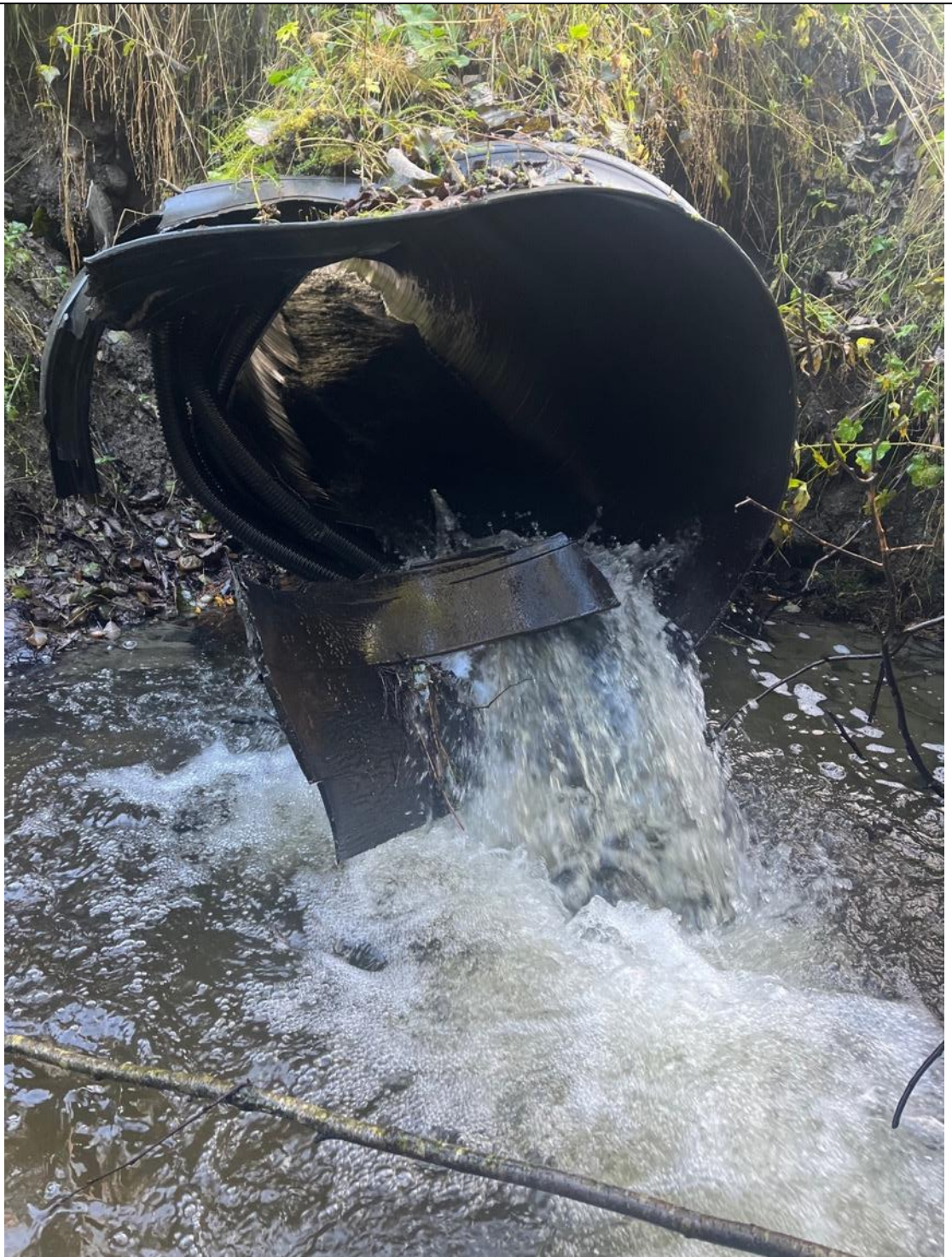
Kulvert i dårlig stand i Kvellstadbekken.
