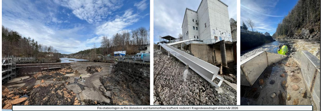
Fra etableringen av fire Åleledere ved Kammerfoss kraftverk nederst i Kragerøvassdraget vinter/Vår 2026
