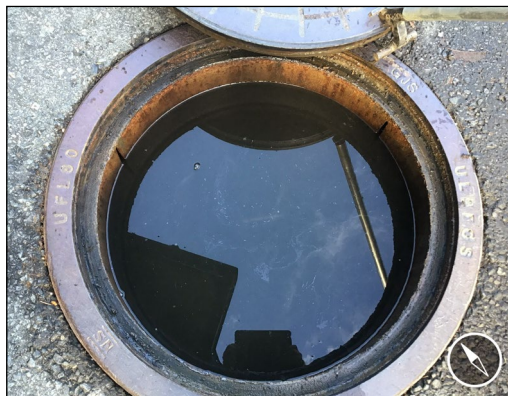
Figur 12. Eksempel på vannfylt vannkum.
