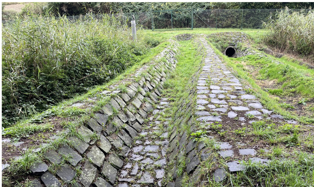
Figur 13. Overløp til renne fra filter 1 til venstre, og innløp til filter 2 til høyre.
