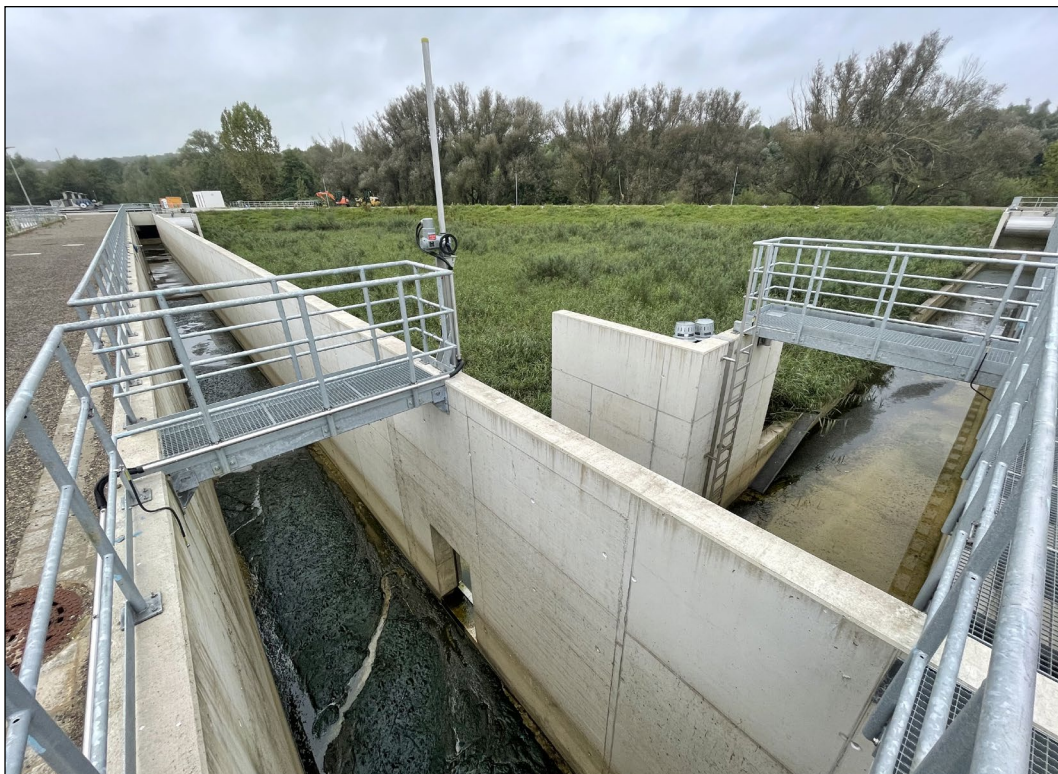
Figur 4. Her sees 1 av 6 kammer i VBO anlegget Aachen-Soers. Anlegget er tilknyttet innløps-overløpet til renseanlegget for 200 000 PE. Overløpsvannet fordeler seg i to kanaler som overtoppes og sprer avløpsvannet inn over takrørene. På denne måten fordeles vannet utover filteret på en skånsom måte. Grunnvannet som står høyt i området, ble senket før anlegging. En membran hindrer lekkasje fra VBO til grunnvannet. Det er benyttet «standard filtermedia», som er 0,75 m dypt. Det ble plantet 6 takrør per m 2 .
