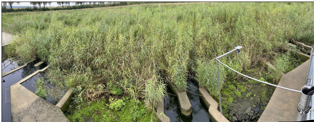
Figur 8. Panoramabilde av RSFplus anleggets tre innløp (fotoet har fortegnet innløpene som normalt ligger på en rett linje). I dette tilfellet er det kun sektor 1 som mottar renset avløpsvann. Legg merke til kanalene som fordeler avløpsvann ut i filteret for de overtoppes slik at vannet fordeler seg i filteret.
