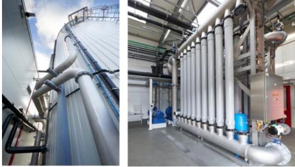
Digester + UF skid
