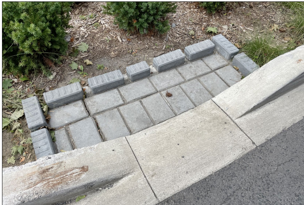
Figur 10. En slamfelle reduserer energien på vannet som strømmer inn, og samler skrammel og skrot fra gata (Foto: B.C. Braskerud).
