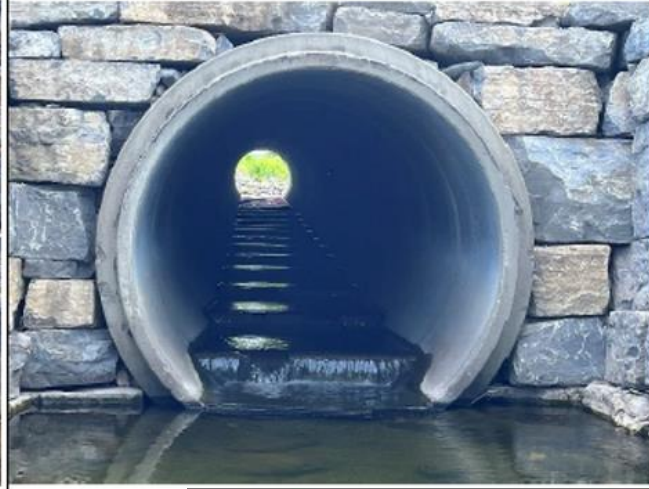
Bilde 9. Betongs betongterskler.
