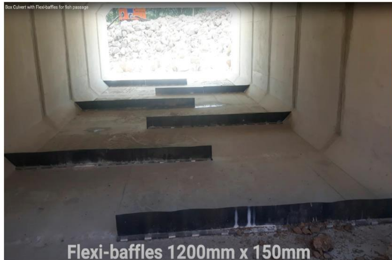
Figur 24. Eksempel på fleksible strukturer montert i flatbunnet kulvert tilsvarende situasjonen under Nydalen bru. Hentet fra Fish passage Action Team, New Zealand. https://youtu.be/iRBxn93bZNo
