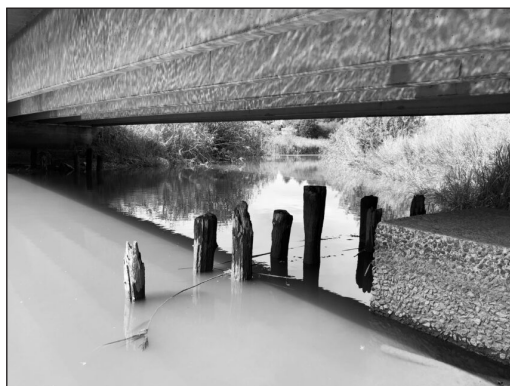
Seutelva under dagens veibro. Rester av den gamle broa står igjen, som et minne fra prisvinnerens barndom.
