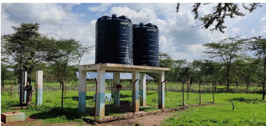
Brønn og vanntanker i Dang'aida
