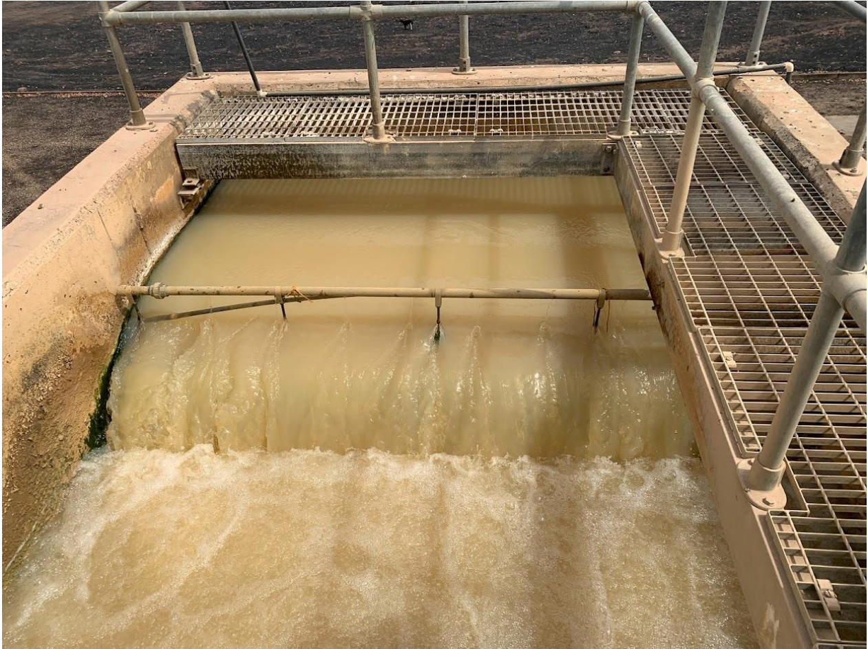
Dosering av aluminiumsulfat til koagulering og flokkulering, drikkevannsrensing
