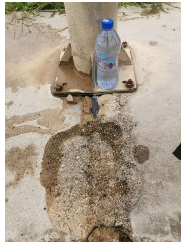
Påkoblingen til en mekanisert pumpe, inn på den tidligere hovedbrønnen. Det ble tatt prøver i både den påkoblede vanntanken, og fra selve brønntaket da det mistenkes forurensning. Dette er den eneste kilden til 300 skoleelever i Dachio
