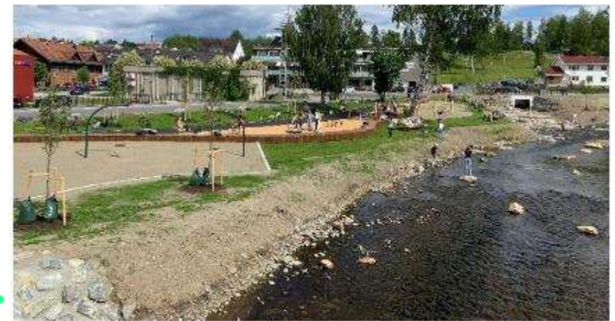
Utvidelse av elva til flomsikring med flomsone brukt som elvepark i Brandbu/Gran kommune (Foto: Gran kommune) 5
