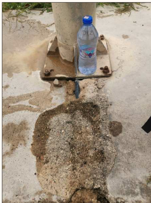
Påkoblingen til en mekanisert pumpe, inn på den tidligere hovedbrønnen. Det ble tatt prøver i både den påkoblede vanntanken, og fra selve brønnuttaket da det mistenkes forurensning. Dette er den eneste kilden til 300 skoleelever i Dachio.
