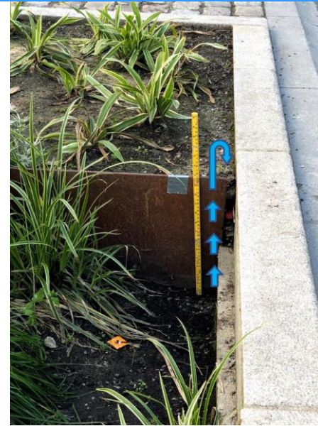
Observert skjev jordoverflate i regnbed 7
