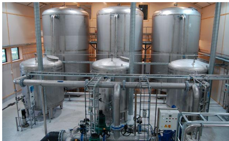
Ozonering - Biofiltrering Ca 35 anlegg
