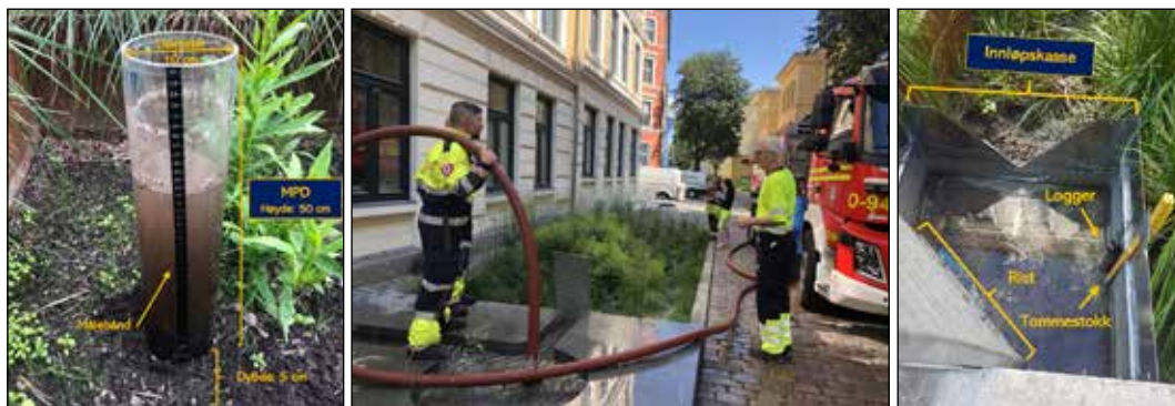
Figur 2. Venstre: Viser utseendet til MPD-infiltrometeret, og størrelsesforhold. Midten: Feltforsøk «oversvømmelse» i R7. Høyre: Innløpet i R1, med forlenget V-overløp og verktøy som er benyttet i testingen.
