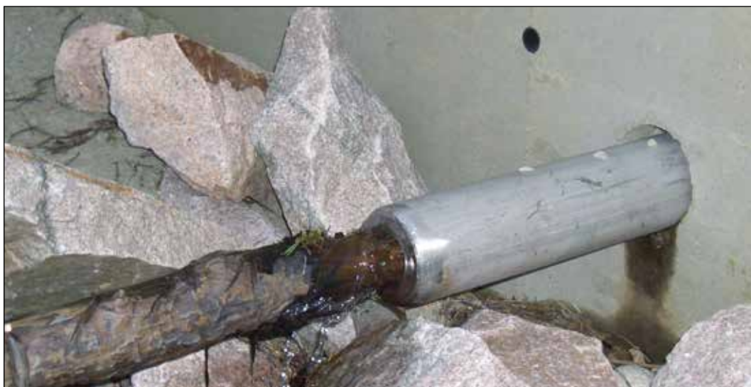
Figur 1. Plombering av et rør som skulle ha sikret vassdragslovens krav om slipp av alminnelig lavvannføring for et kraftverk som var vedtatt ikke å være konsesjonspliktig. Bildet ble tatt under en ikke-varslet inspeksjon i 2010. (Foto: NVE).
