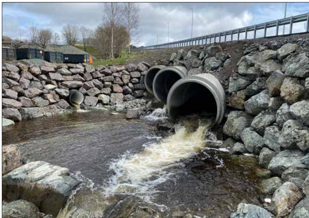
Figur 6. I veianlegg ferdig i 2019 er det valgt tre underdimensjonerte betongrør som løsning for å få fisk og vann forbi veien. Resultatet er vanskelige vandringsforhold for fisken, med montering av terskler i rør og oppgravning av kulper nedstrøms som påkrevde nødløsninger i etterkant. Hvorfor valgte man ikke bevart elvebunn og halvkulvert med stor diameter som løsning her? Botngårdselva i Bjugn kommune. Fylkesveg 710. Foto: Morten André Bergan, NINA.
