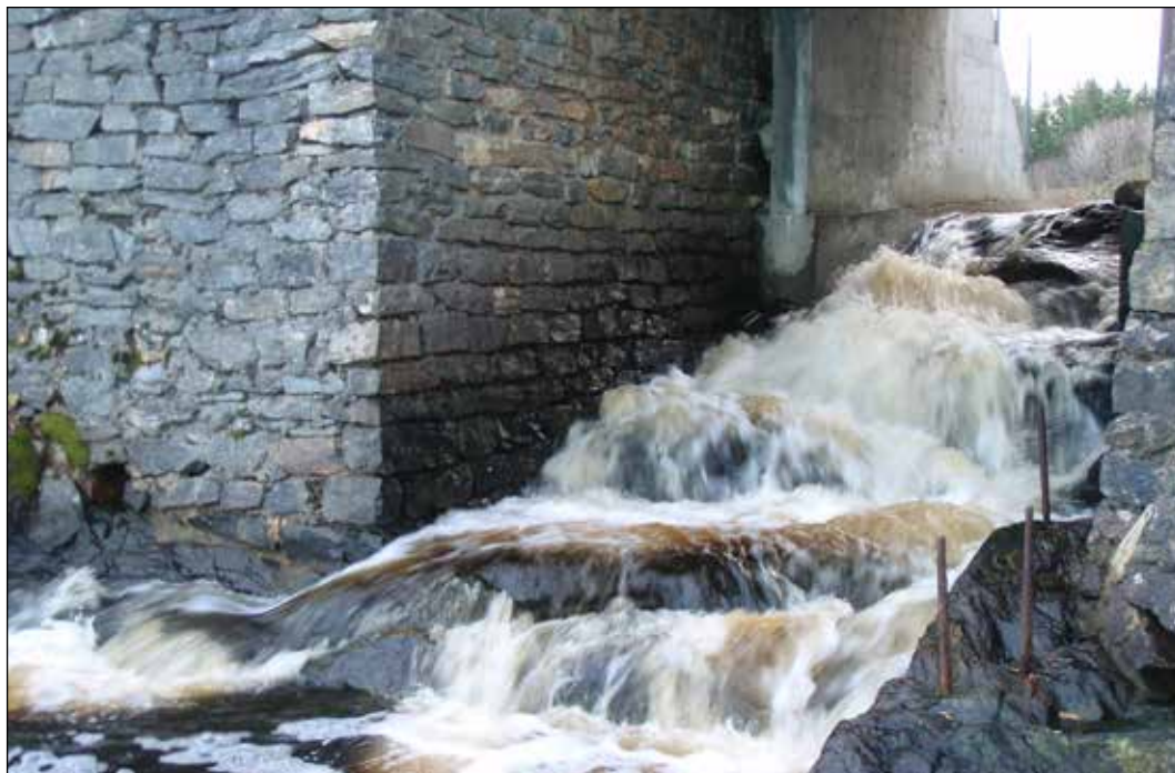
Figur 4. Veikrysningen for Undåsvatnets utløp til sjøen på Hitra er murt smalere, slik at et helt sjørretvassdrag med innsjø og tilløpselv har fått svært vanskelige oppgangsførhold for sjørret under Melandsjøveien (veinr. 6456). Foto fra 2011. Status i dag er ukjent. Foto: Morten Andre Bergan, NINA.
