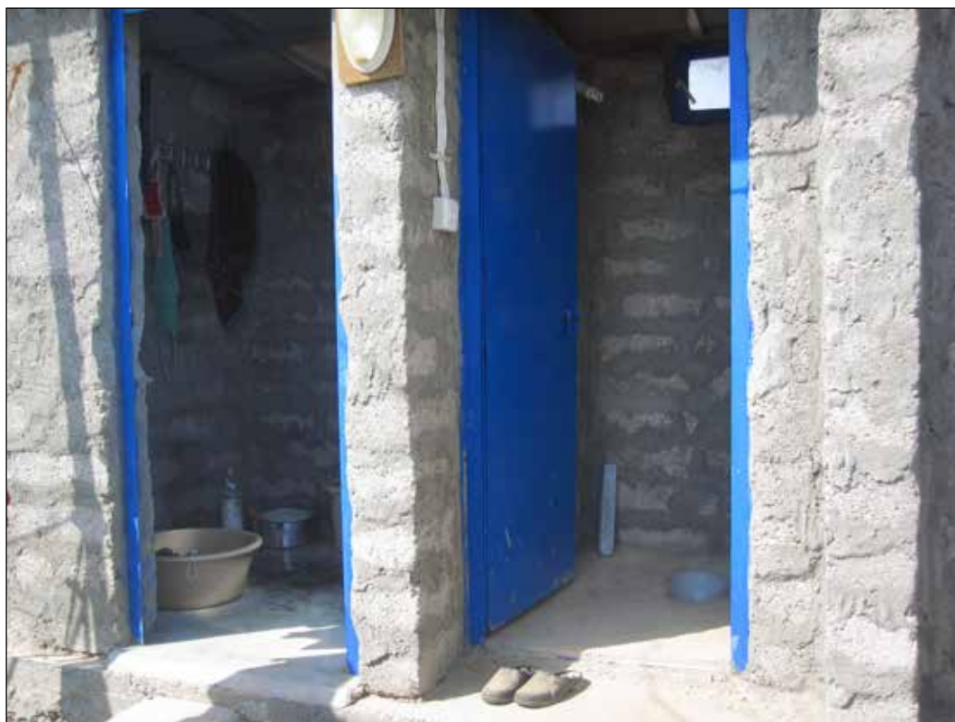
Bilete 2 og 3. Flyktningleir i Nord-Irak. Kvar familie har eit telt med tilhørande tilbygg med privat do og dusj. Alle hushald har eigen vasstank på taket.
