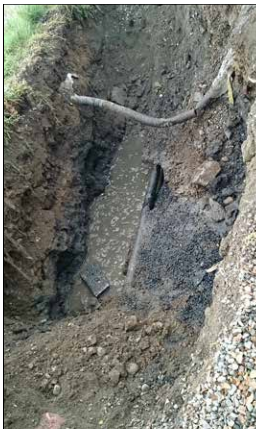
Figur 1. Eksempel på anlegg som er gått ut på dato.
