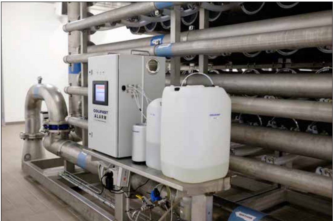
Figur 6. Det kommunale vannbehandlingsanlegget i Jevnaker leverer vann til ca 5000 personer. Basert på erfaringer med vannbehandlingen har vannverket valgt å installere en Colifast ALARM på filterriggen for å øke sikkerheten.
