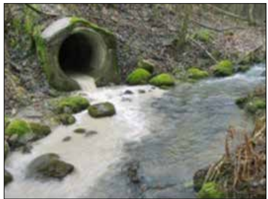
Ukontrollerte utslipp via overvannsledning til sårbar resipient.
