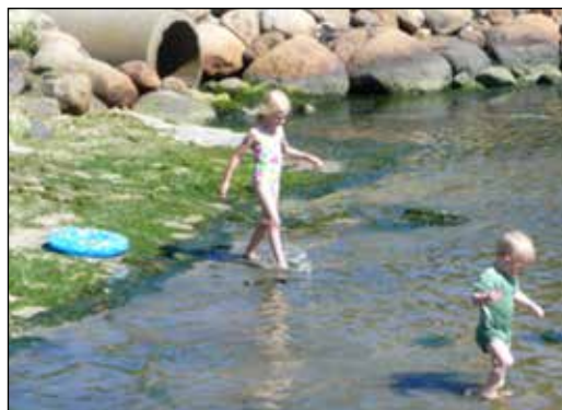
Forurenset overvann med utslipp til badeplass.
