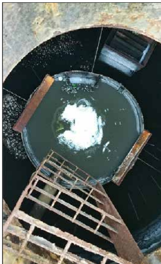
Oljeutskillere der lokk mangler på utløpskassen oppe til høyre i bildet.
