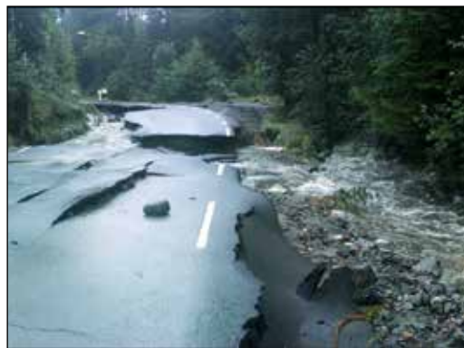
Veien ved Skotelv i Øvre Eiker ble skylt vekk under ekstremværet Frida. (Foto: Christian Dalbakk)
