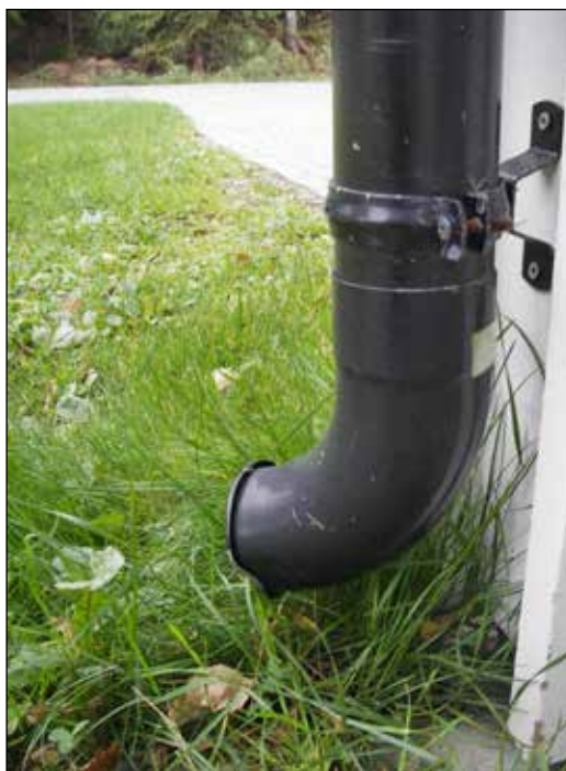
Bilde 6. Frakoblede takrenner kaster vannet ut på plenen og reduserer tilstrømningen til avløpsnett.
