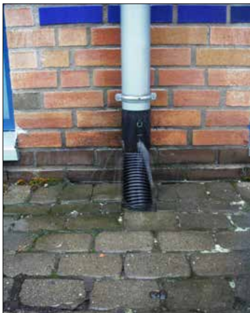
Bilde 7. Takrenner med underjordisk avløp kan lettere tettes, med vannskade og frostsprengning av røra som resultat.
