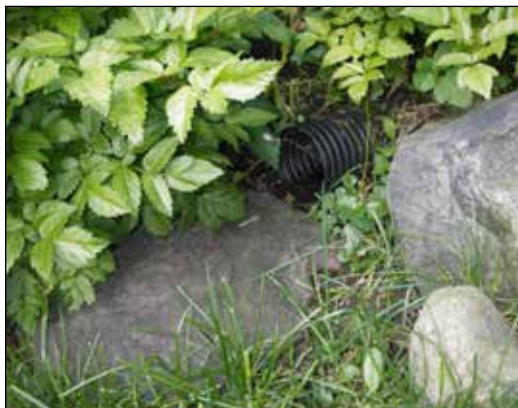
Bilde 4. Vannet ledes fra utløpet over en helle. Hellen hindrer gjengroing og muliggjør at man kan se vannspruten fra stuevinduet ved styrtregn.
