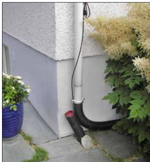
Bilde 5. Frakoblet takrenne med varmekabel for mulig opptining. Tidligere rør til avløpsnett er blendet.
