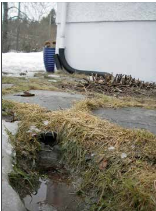
Bilde 8. Frakoblet takrenne leder vann i rør under bakken og ut på plenen.
