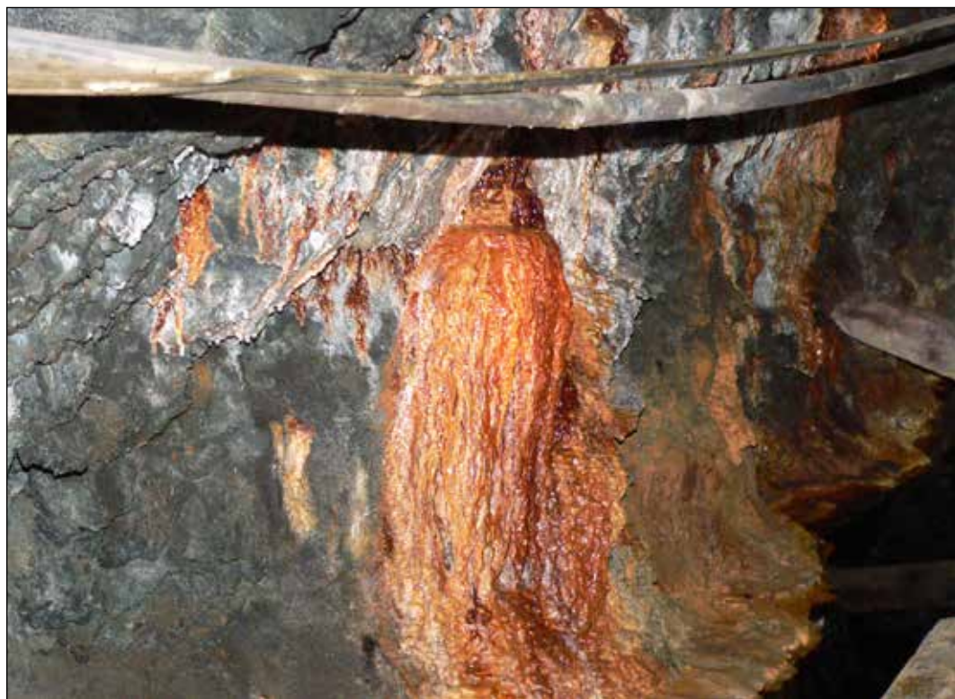
Figur 1. Jern som er løst i grunnvann kan felle ut på tunnelvegger ved tilgang på oksygen. Her fra Follidal gruver.
