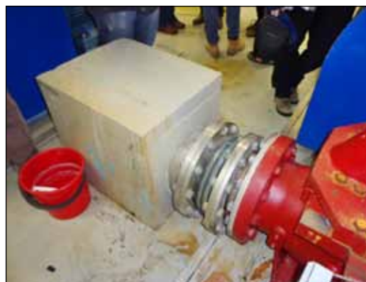
Forankringskloss ved en av pumpene på Jakobsli pumpestasjon. Det er store krefter i sving, når trykket er høgt, evt. forsterket av trykksvingninger, som trykkstøt.
