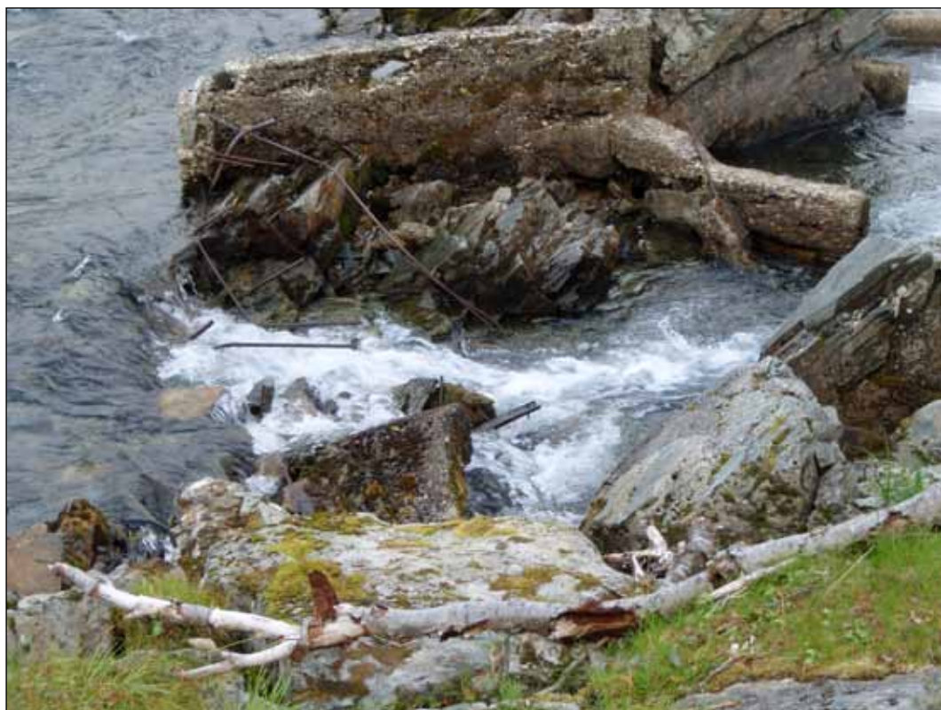
Figur 4. Ødelagt laksetrapp fra 1970-tallet i Finnmark. Naturkreftene har over tid brutt ned konstruksjonen, og armeringsjern står igjen med fare for å skade fisken.
