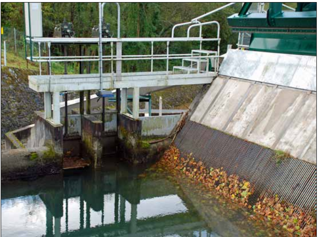
Bilde 3. Eksempel på en skråstilt og finnmasket varegrind med små lysåpninger ved et elvekraftverk i Gave d'Ossau i Syd-Frankrike. En alternativ nedvandringsvei for fisk er etablert nært inntil varegrinda. Foto: M. Kraabøl.
