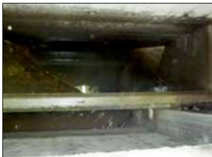
Overløpsterskelen som det kan strømme sjøvann over og inn på avløpssystemet
