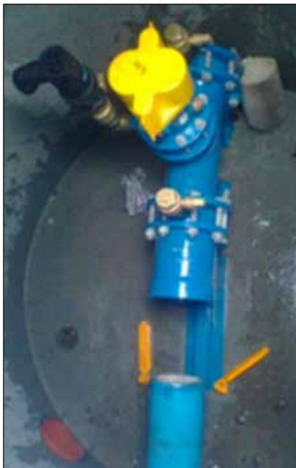
Figur 1. DN150 vannledning; armatur forskjøvet seg 30 til 40 cm i endekum under trykkprøving.
