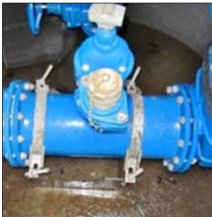
Figur 2. DN300 vannledning; armatur forskjøvet seg 18 cm under trykkprøving.
