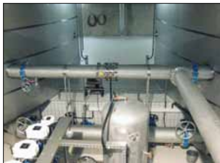
Figur 6. Bilde av anlegget med høgdebasseng og pumper (Foto: S. T. Thorolfsson).
