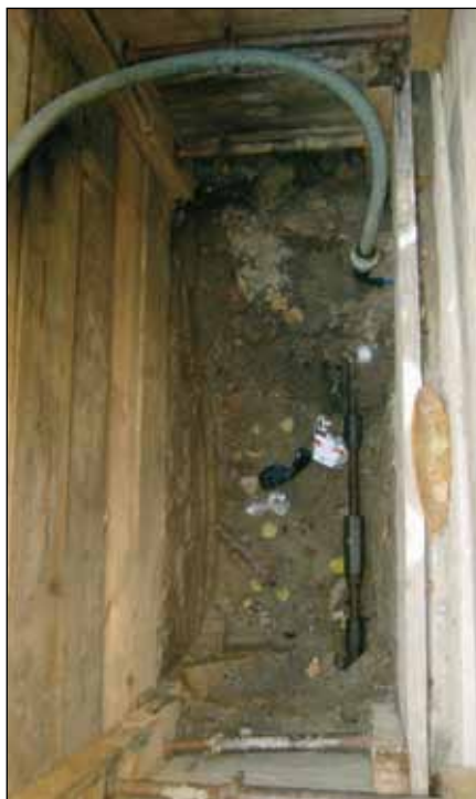
Figur 2. Trekkakselen i en stemplet grøft er vist. Trekkraften kunne komme opp i 15 tonn. Reservevannforsyning er ordnet fra en provisorisk vannledning opp på bakken (Foto: S. T. Thorolfsson).
