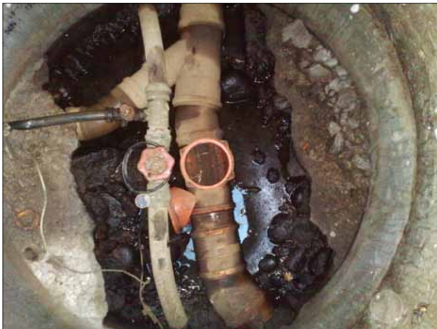
Bilde 1. Eksempel på vann og avløp i samme kum, november 2008.
