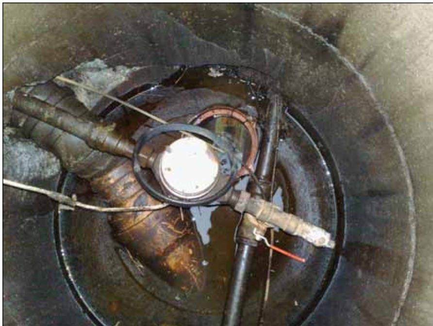
Bilde 2. Såkalt "fellesgrav". Åpne selvfallsledninger med drikkevannsledning påmontert måler og dreneringsventil. Stor fare for innsug. Foto: Kasper Nordmelan
