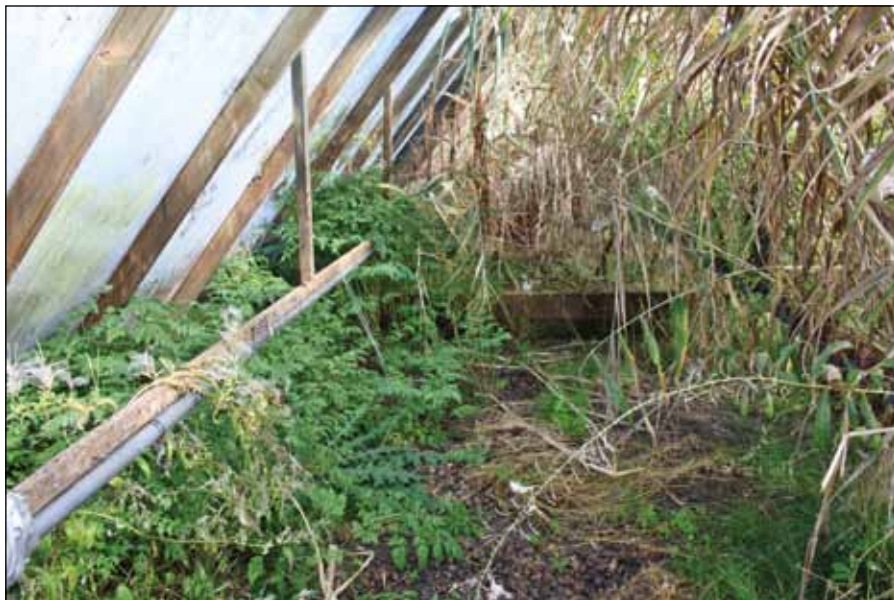
Figur 3. Gjengroing og dårlig fordeling av slamavskilt avløpsvann preger anlegget. Foto: Jan-Petter Kongsberg.
