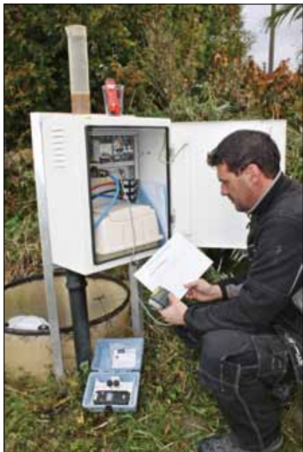
Figur 1. Servicebesøk på minirensanlegg med loggføring via PLS, sedimenteringsprøve, PH og ortofosfatmåling. Foto: Jan-Petter Kongsberg.
