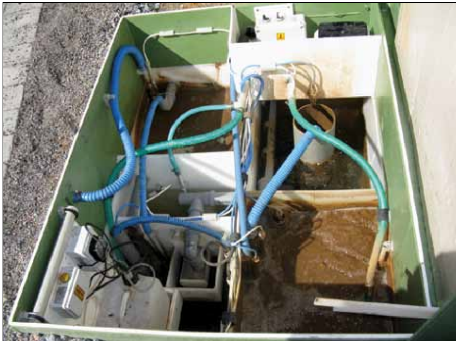
Bild 3. Topas minireningsverk ser ved en första anblick kompliserat ut med all "inredning". Fördelen med denna konstruktion är att när man lyfter på locket kommer man åt allt uppifrån även då verket är i drift. (Foto: Maria Hübinette).
