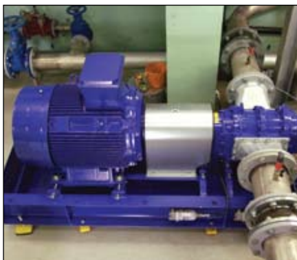
Figur 3. Difgen montert på rørstrekk.
