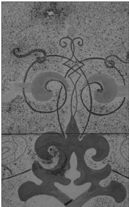
Figur 2. Eksempel på svertesoppangrep (små sorte prikker) på innvendig dekorert panel.
