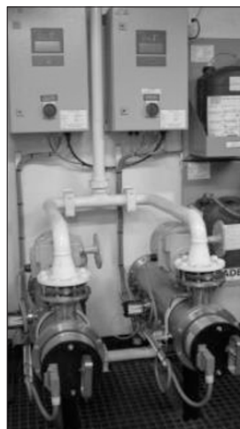
Figur 3. UV-anlegget på bildet består av to kontrollskap og to bestrålingskamre som begge er utstyrt med UV-sensor på siden og manuell renseanordning foran (Foto: Folkehelseinstituttet, Bjørn Løfsgaard).
