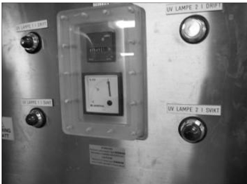
Figur 4. Kontrollskap for UV-anlegg. Signallys viser om UV-lampene lyser, timetelleren (sort) angir hvor lenge anlegget har vært i drift, og intensitetsmåleren (hvit) viser lysintensiteten inne i UV-kammeret (Foto: Folkehelseinstituttet, Eyvind Andersen).
