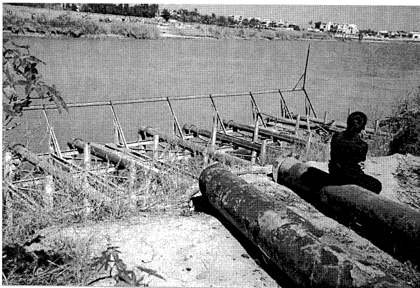
Figur 3. Vanninntak i Tigris for Al-Karama vannverk, Bagdad.
